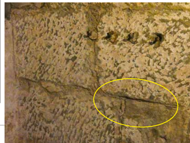
Steinfrass am Sandstein in den Liegenschaften am Pavillonweg.
